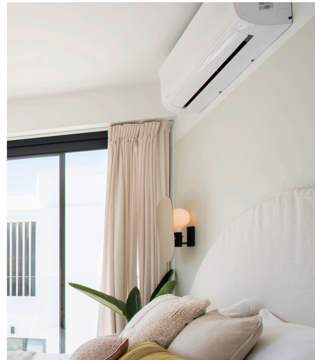
Preinstalación aire acondicionado por splits Sistema de climatización aire-aire, splits por estancias.
